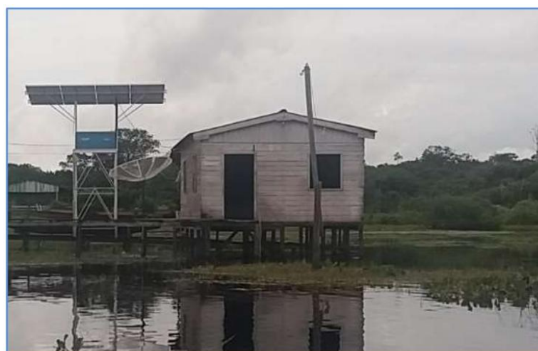
Figura 51 - SIGFI instalado no Pará. Fonte: (Eletrobras, 2021).
