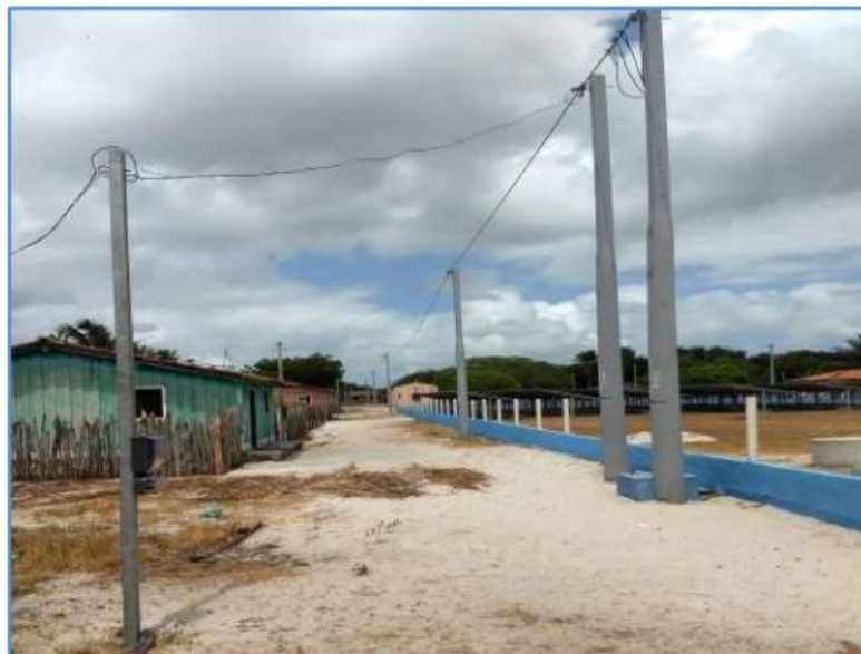
Figura 54 - Minirrede de Distribuição. Fonte: (Eletrobras, 2021).
