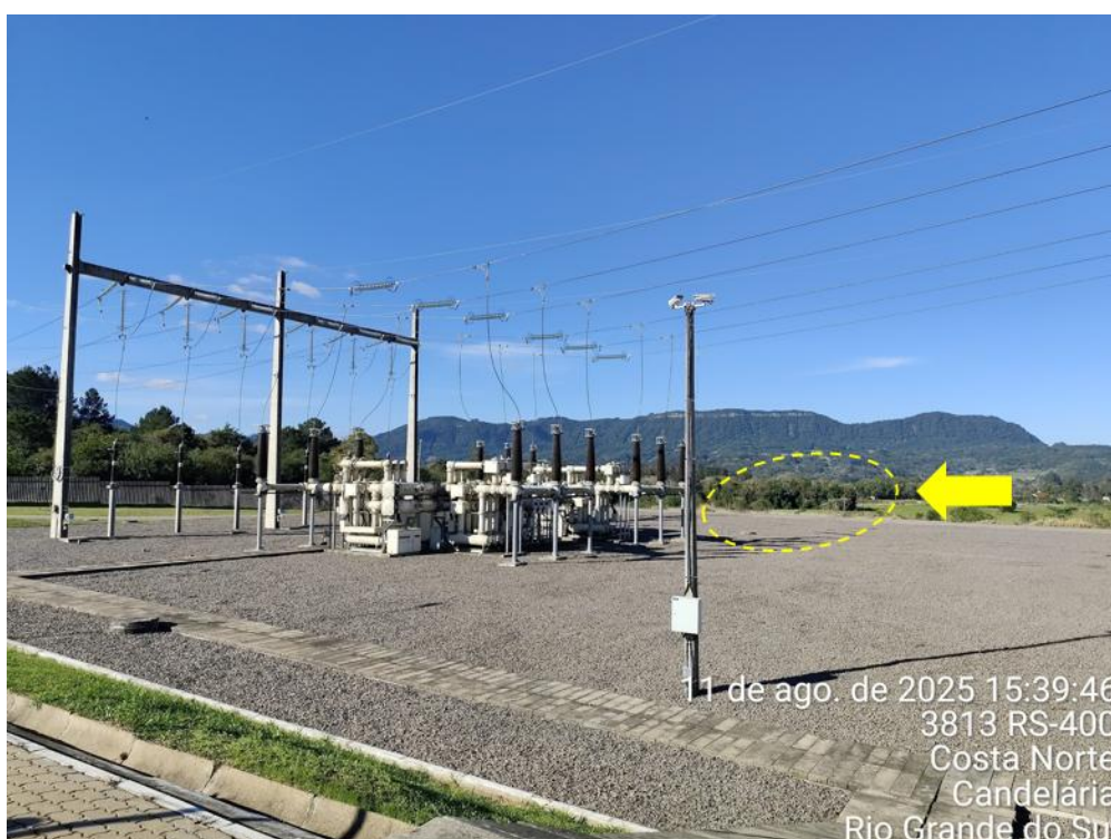
Figura 47 – SE Candelária 2 e espaço para entrada do seccionamento.
