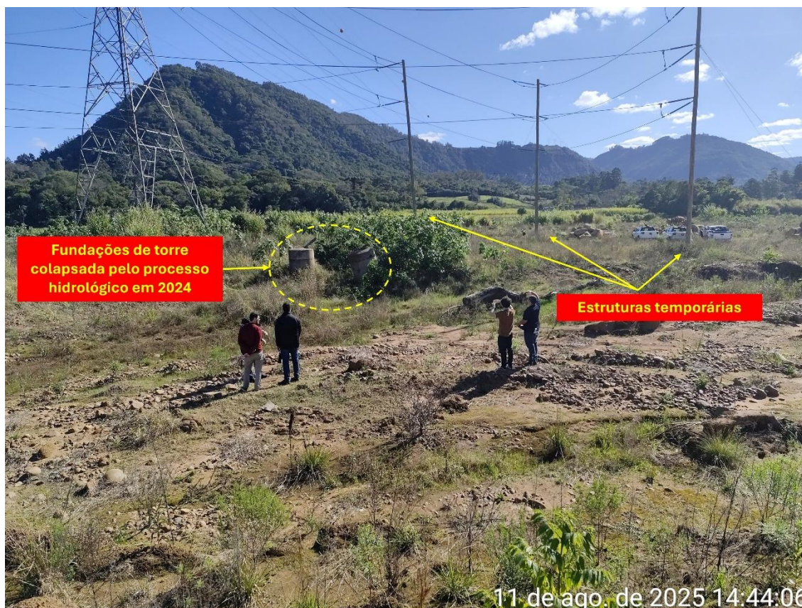
Figura 26 – Inspeção de campo em local afetado por inundações, Candelária/RS fonte: EPE, 2025).
