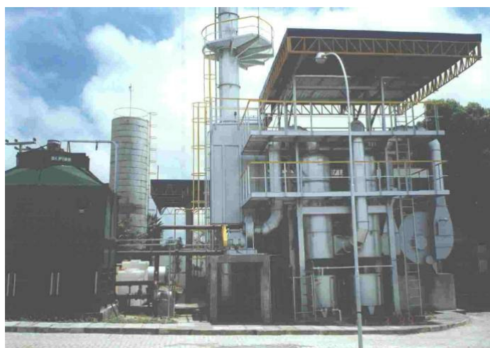
Figura 42 - CTRP – Fortaleza – Sistema de tratamento de gases.
