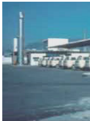
Estação de purificação, compressão e abastecimento de biogás para uso em veículos COMLURB
