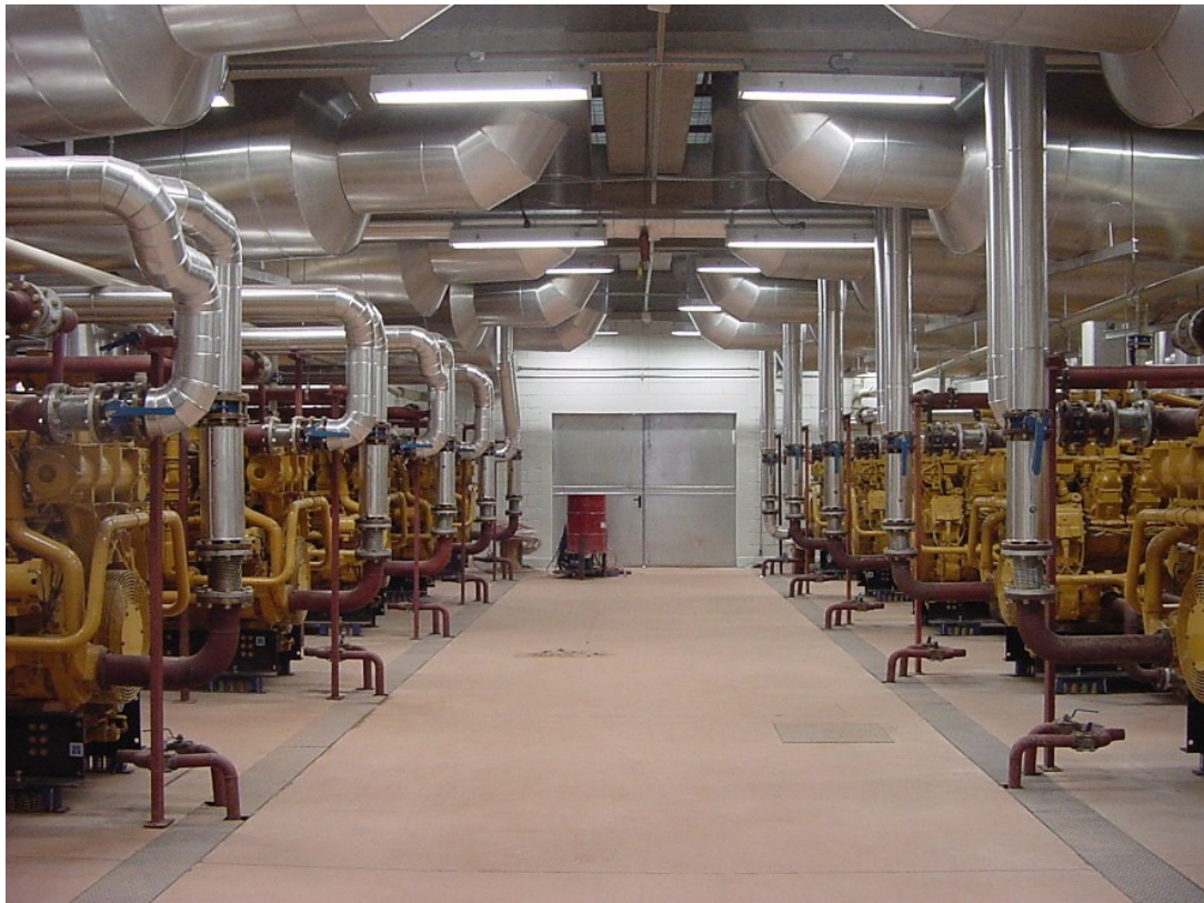
Figura15 – Casa de Motores a Biogás no Aterro Bandeirantes, São Paulo
