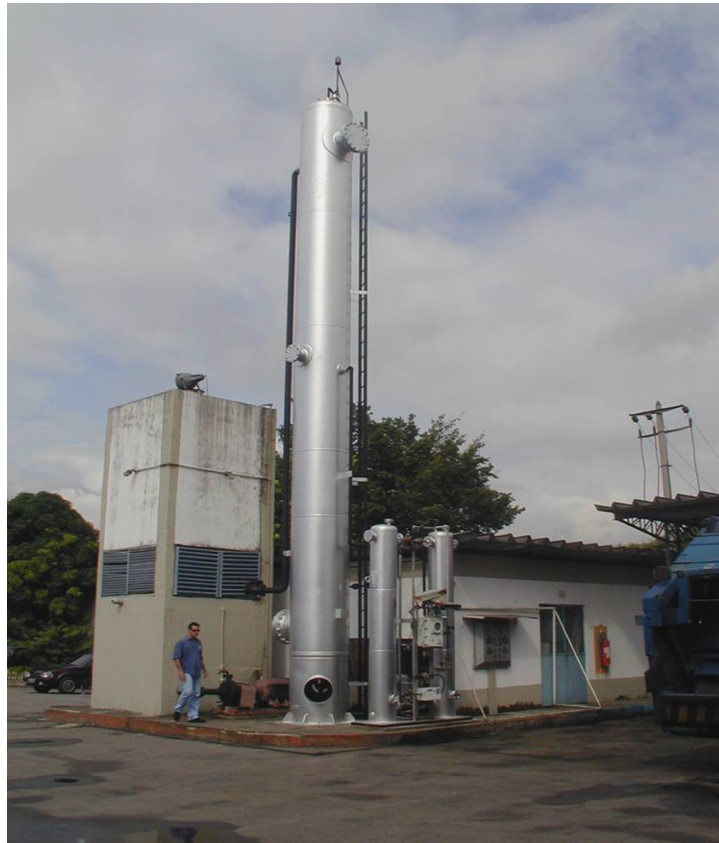
Figura11 – Instalações da COMLURB para produção de GNV do GDL
