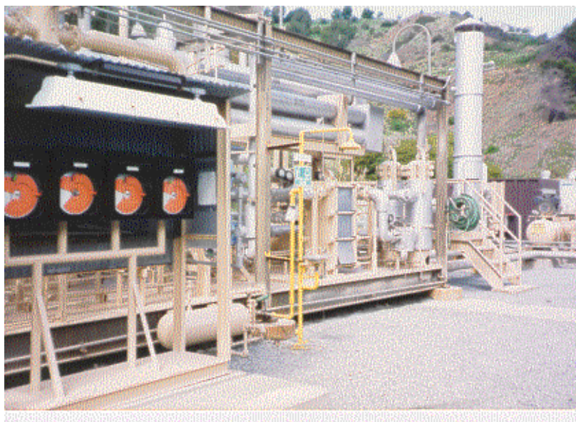
Figura9 – Vista Frontal de Moderno Sistema de Limpeza de Biogás de Aterro nos EUA
