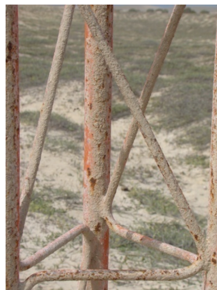
Figura 82. Torre oxidada por ação da maresia.
