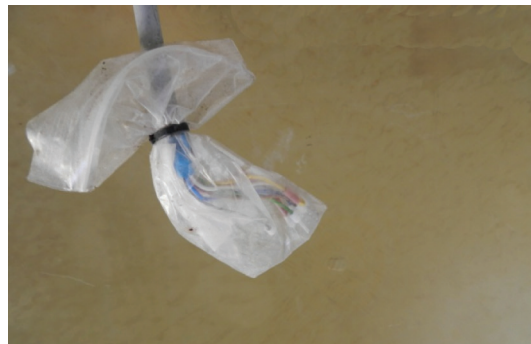
Figura 73. Cabos dos sensores protegidos com plástico.
