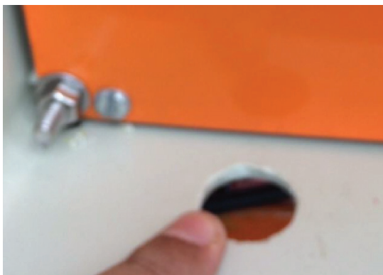
Figura 74a. Entrada de cabeamento da caixa do datalogger não utilizada e sem vedação.
