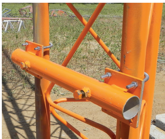
Figura 50b. Suporte horizontal fixado na torre.
