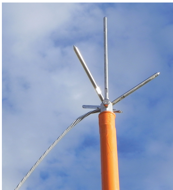
Figura 42. Detalhe de um para-raios tipo Franklin.
