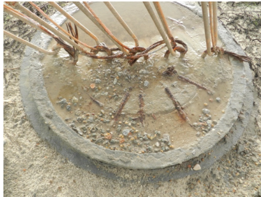
Figura 79b. Ancoragem deteriorada.
