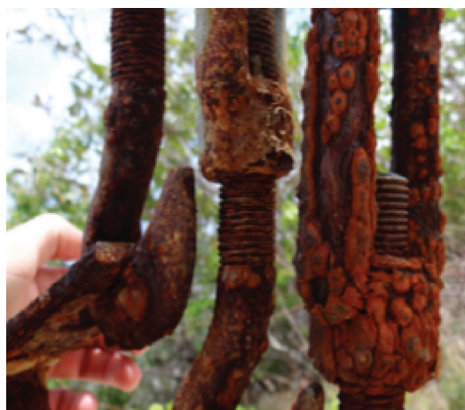
Figura 18. Ferrugem nos esticadores dos estais.
