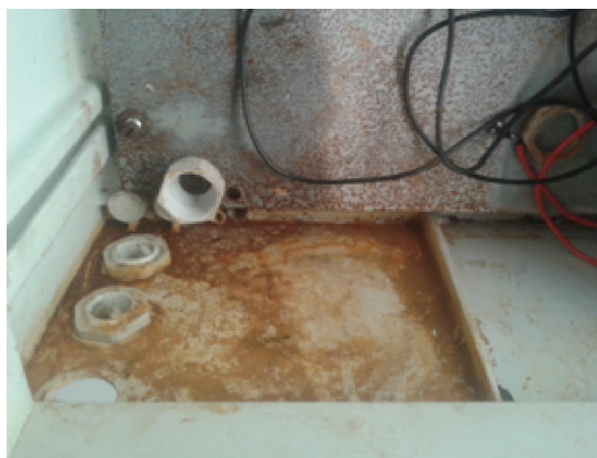
Figura 75. Caixa com problemas de vedação.
