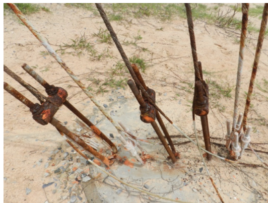
Figura 80b. Esticadores deteriorados.
